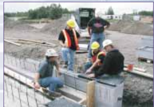
Installation der Belüftungstechnik mit Installationshinweisen der UTV vor Ort mit dem örtlichen Bauunternehmer. UTV Kompostieranlage in Kanada
