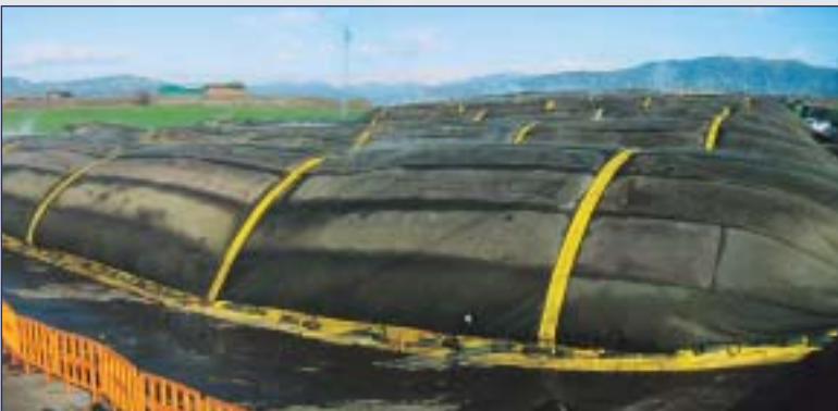
Kompostierungsanlage Fervosa, Spanien
